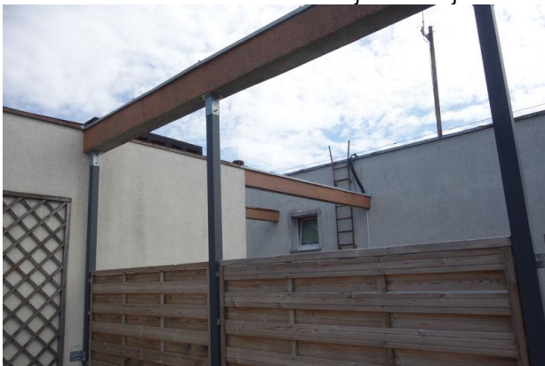
Fot. 19. Widok elementów w środku budynku.
