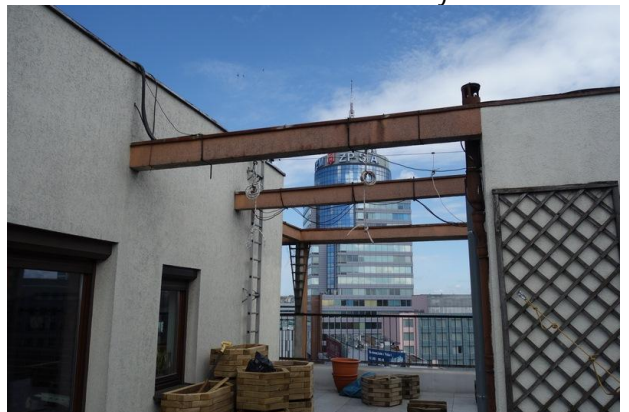
Fot. 20. Widok elementów w środku budynku.
