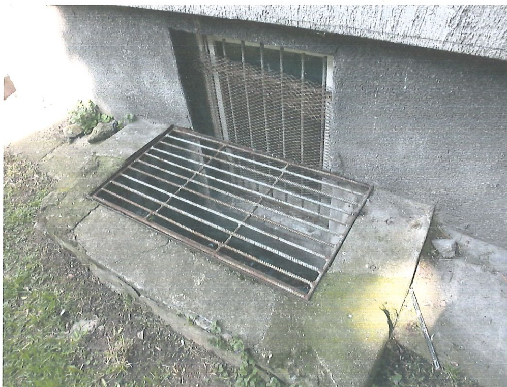
Fot.6 . Studzienki piwniczne do remontu, kraty do wymiany
