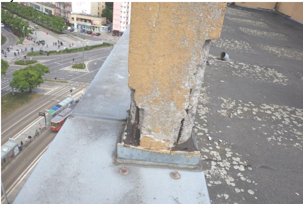
Fot. 3. Widok słupa – znaczna korozja, widoczne zbrojenie.
