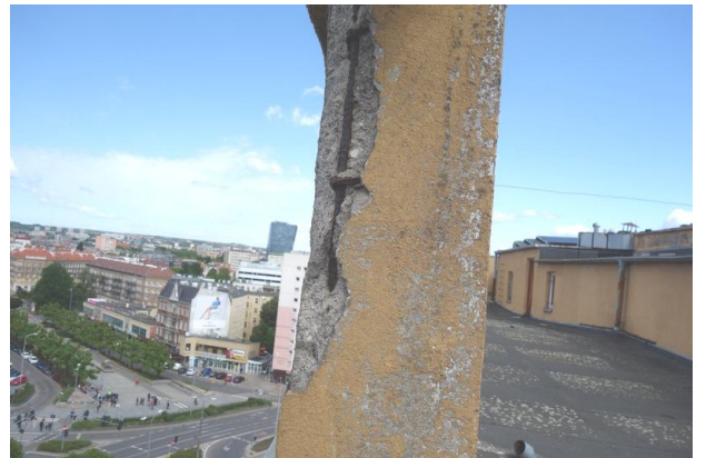
Fot. 4. Widok górnej części słupa - znaczna korozja, widoczne zbrojenie.
