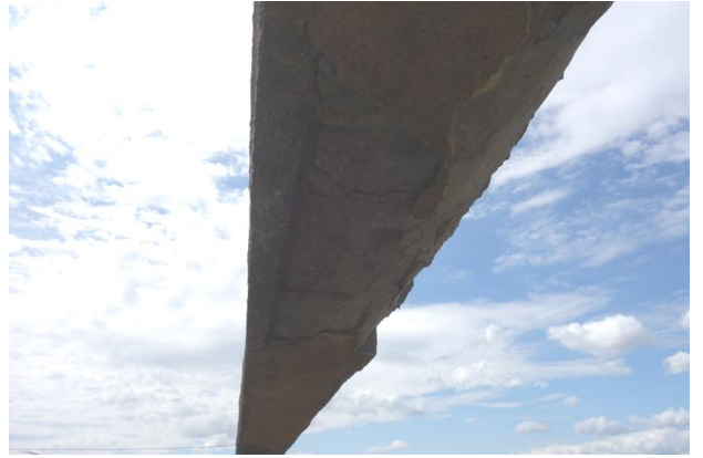
Fot. 2. Widok odspojenia otuliny i zbrojenia belki.
