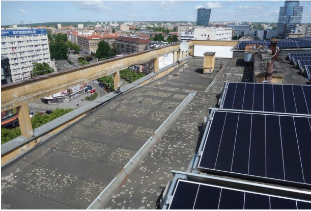
Fot. 1. Widok ogólny elementów – znaczna korozja, widoczne zbrojenie.
