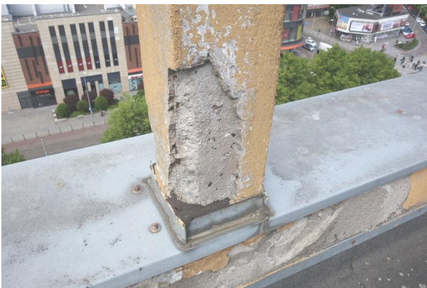
Fot. 5. Widok ogólny elementów – ubytki betonu.
